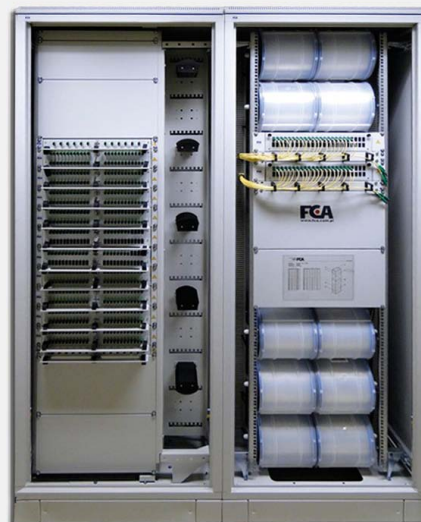
Szafy rozbiegowe z wyposażeniem
